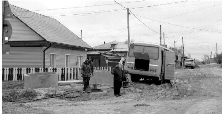
Установка колодцев прокладка новой полипропиленовой трубы проводится на улице Красноармейской. / ВСЕ ФОТО НАТАЛЬИ КОЧАРИНОЙ.
