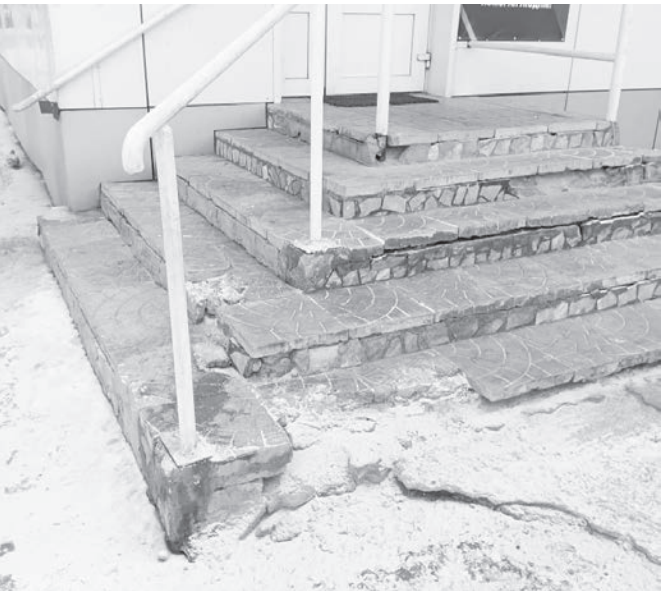
● Крыльцо разбито - не порядок. Устранить до 1 апреля!
