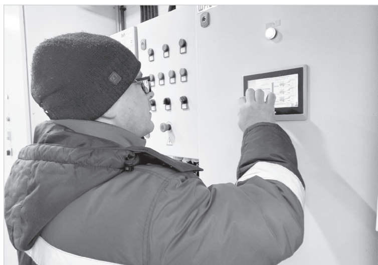
Станция оснащена современным оборудованием и практически автономна || Фото Елены КОВАЛЕВОЙ
