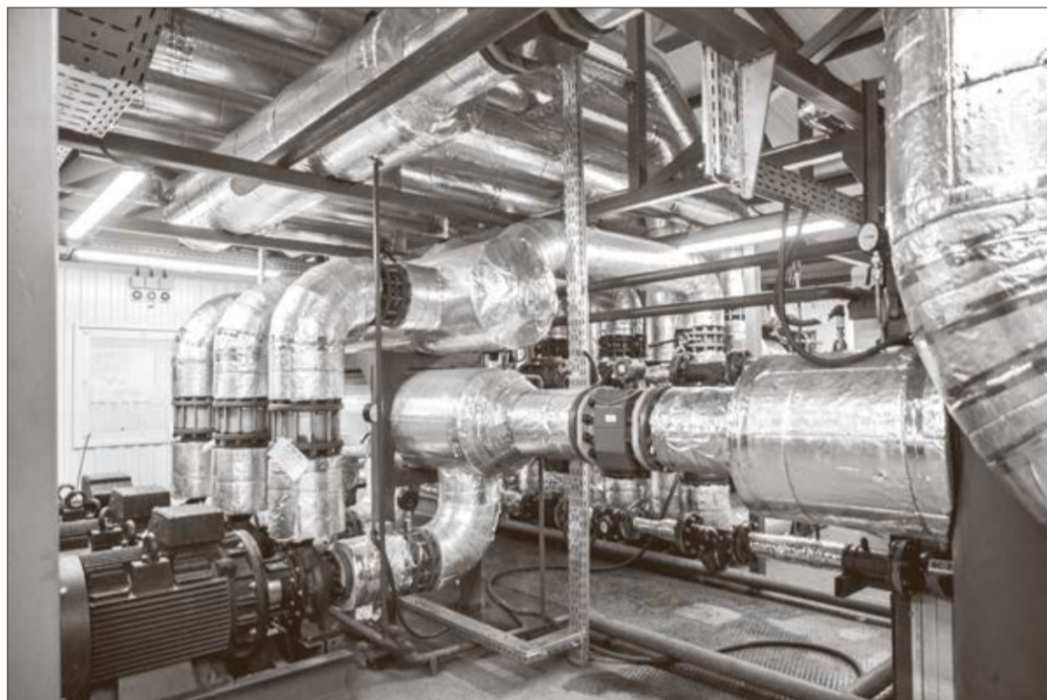
Котельное оборудование не связано с тепловым контуром. Теперь грязь, которая накапливается в теплосетях за время эксплуатации, не будет заноситься в котлы. ФОТО: ЛАРИСА БАКАНОВА, «ХАКАСИЯ»
