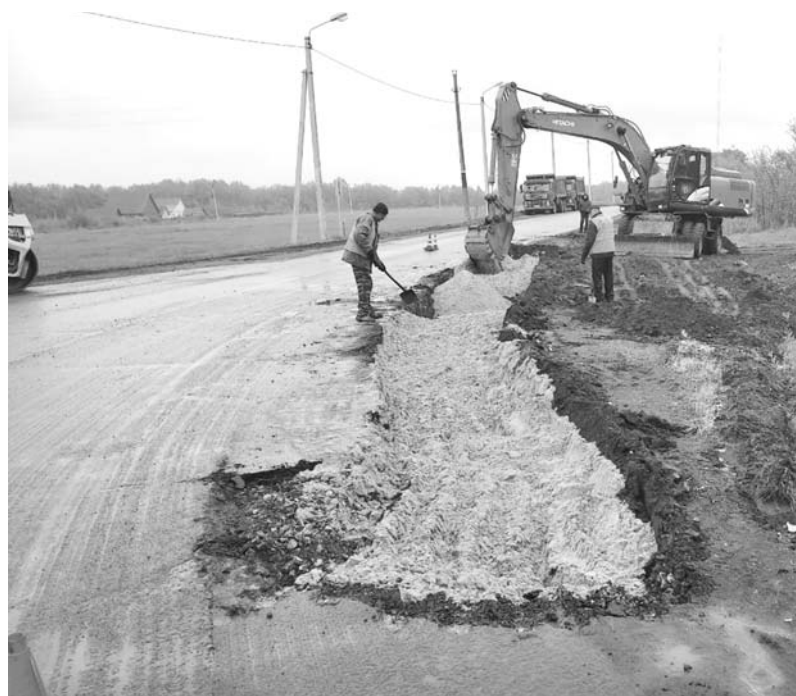
Дорожникам пришлось исправлять провалы, возникшие на местах, где отсутствовали ЖБК-плиты в основании дороги.
