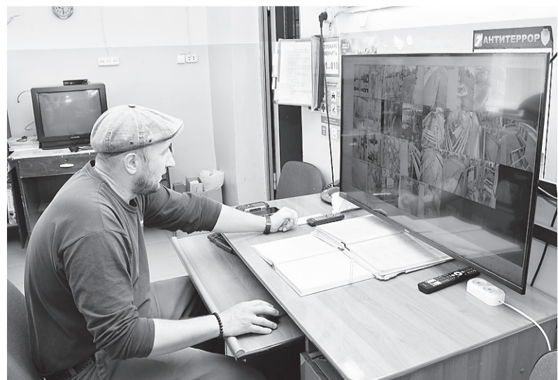
Дежурный оператор котельной №9 Евгений Дзюба контролирует работу автоматизированных котельных
