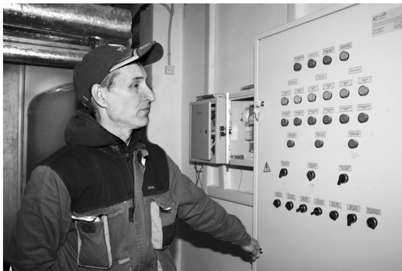
▲ Алексей у блока управления тепловым пунктом дома
